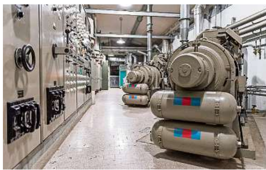
Nach wie vor bereit: die Notstromaggregate.
